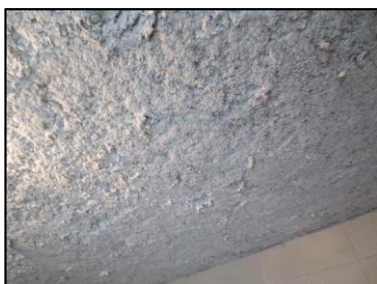
Photo N° 898 ECH-N°1 FLOCAGE -- LOCAL VO RDC Plafonds Flocage
